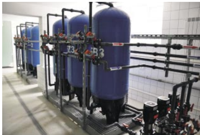
Zautomatyzowany system filtracyjny Sali Amazonia.
