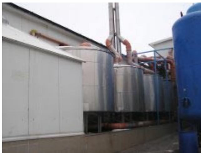
Fot. 2. Bateria biofiltrów zbiornikowych: 4 – cylindrycznych i 1 – prostopadłościennego, wraz z emitarami.
